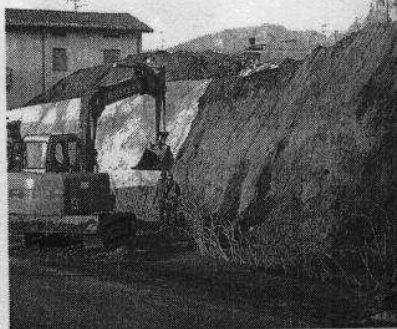
IN DIBATTITO La zona del sinistro, subito dopo il crollo del muro di contenimento.
